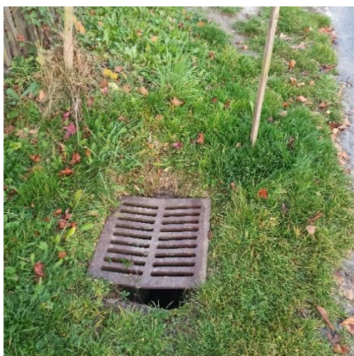
Vpust' v katastrofálním stavu u Vrbového před opravou, jednalo se o jednu z nejhorších v celé obci, která byla velice nebezpečná
